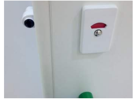
Abb. 3: WC-Tür mit integriertem Klemmschutz mit Weichlippenprofil
